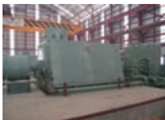
採用例：バイオマス発電機
