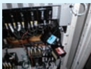
バッテリーレスセンサの設置状況
